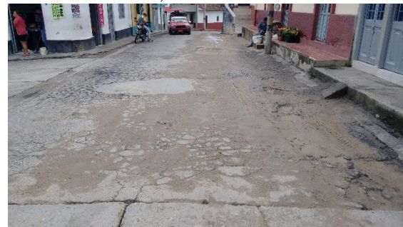
Figura 4. Fallo típico en pavimento flexible.
