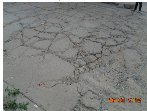
Figura 7. Fallo típico en pavimento rígido.
