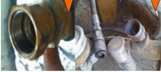
Figura 5. Conexiones y lineras de suministro durante el cambio de lubricante sin los procedimientos de protección adecuados. Fuente: Elaboración propia
