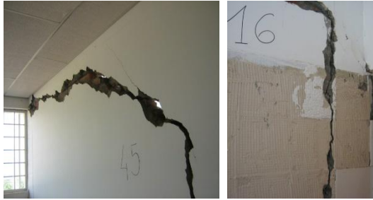
Figura 1. Daños producidos por expansión del suelo
